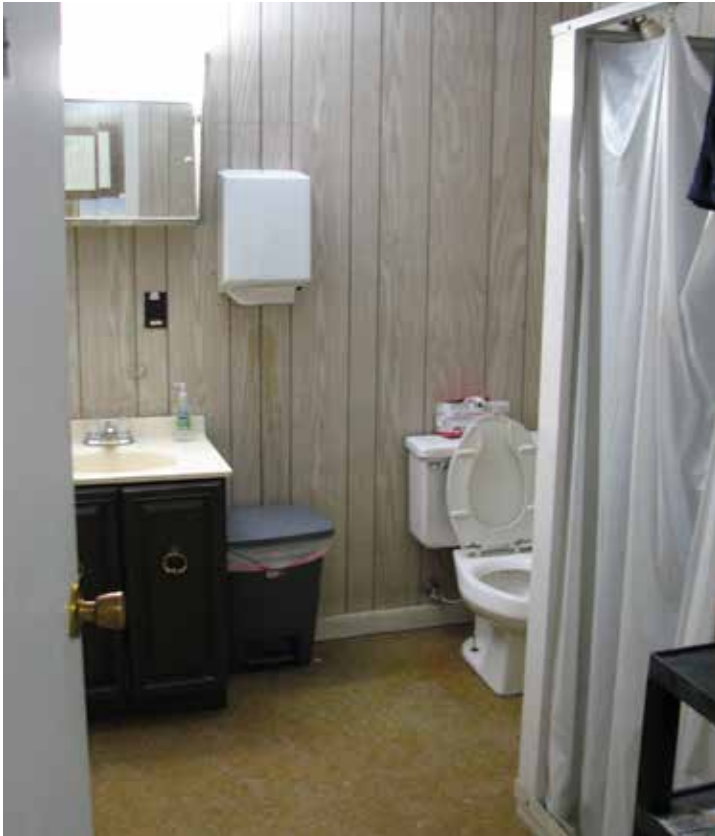
Non compliant bathroom layout
